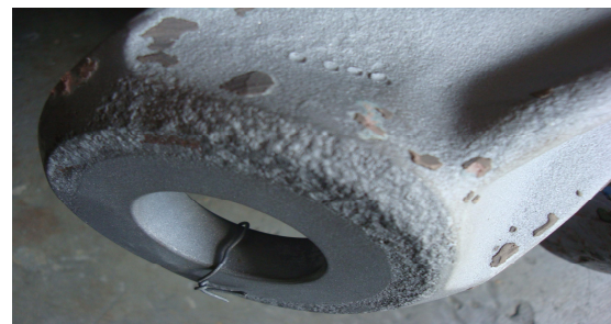
Рис. 3. Корозійне ураження торцевої поверхні вузла-п'ятки підкоса підредукторної рами. Джерело: [6, с. 15].
